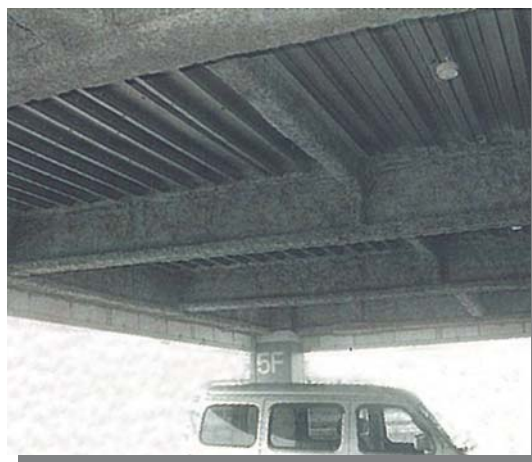
アスベストがむき出しの足立区内の駐車場
